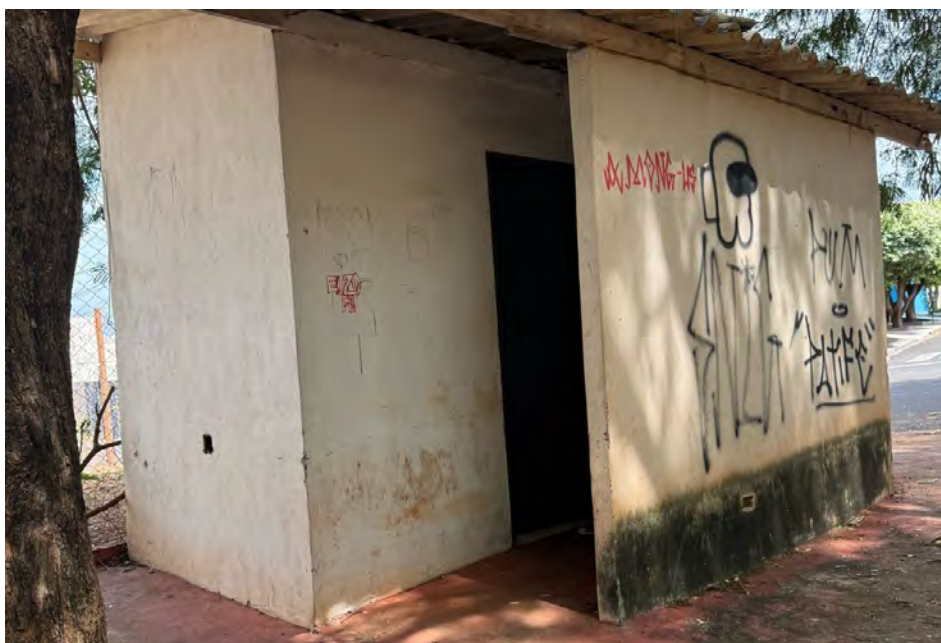
Imagem 4: Sanitários existentes na Praça João Pedro de Moreira Azevedo, frente a Rua Sadamaro Ynohaie
