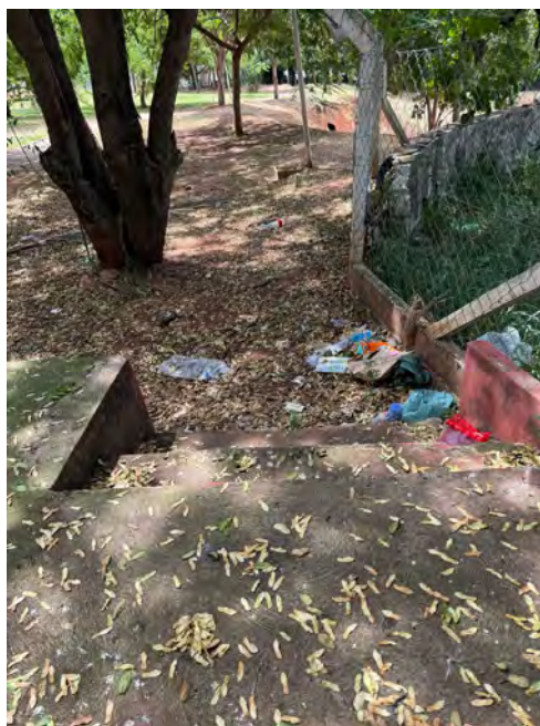
Imagem 7: Escada existente com irregularidades
